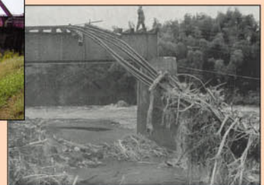
6.26水害後の橋梁 (熊本県大水害写真集より)
